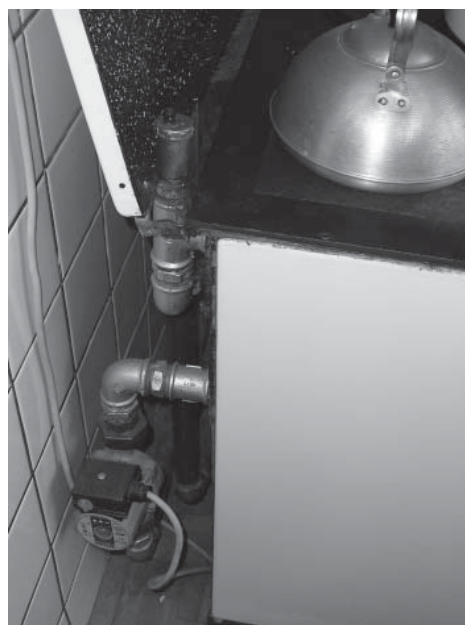
(bild 4) Kuchenherd, Rohrleitung
