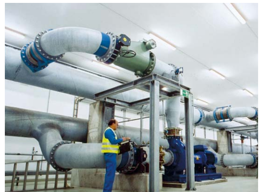
Brauchwasseraufbereitungsanlage in der CargoCity Süd
