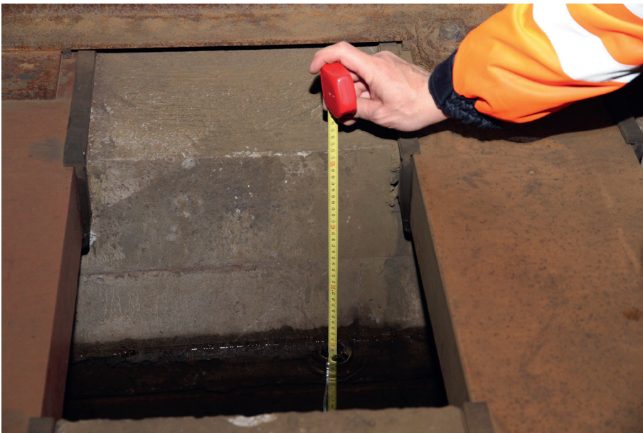
Abb. 4: Stehendes Wasser im Bereich des MFS in der Längsrinne. Der Wasserstand beträgt ca. 20 cm.
