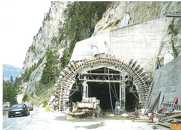
Das Betonieren des Innengewölbes beim Südportal. Mit Blick auf die alte Strasse eingangs der Juliaschlucht.
