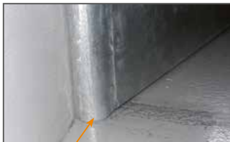
seitliche Räumklappe Achtung: scharfe Kanten! (-> abrunden!)
