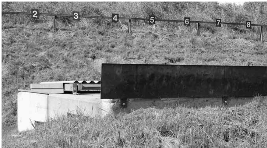
Ansicht der montierten Prellplatte
