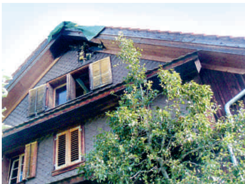
Brand- und Überspannungsschäden als Folge von Blitzeinschlägen.
