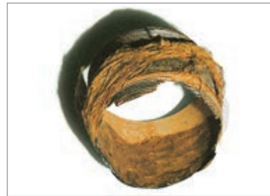
5 Elektrochemische Korrosion an der Berührstelle von verzinktem Stahlrohr und Messingarmatur
