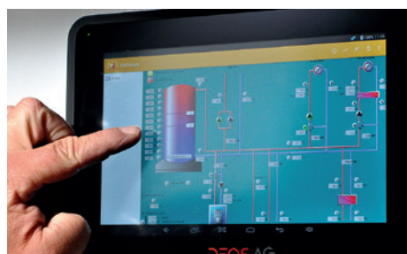
Rechts: Im Regelfall wird das Wärmenetz automatisch überwacht und geregelt. Die mechanischen Temperaturanzeigen sind zur Sicherheit vorhanden.
