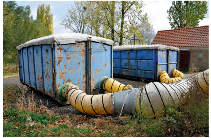
Eine Trocknung für Scheitholz nimmt die Restwärme ab, die nicht von den Heizungen oder der Getreidetrocknung genutzt wurde.
