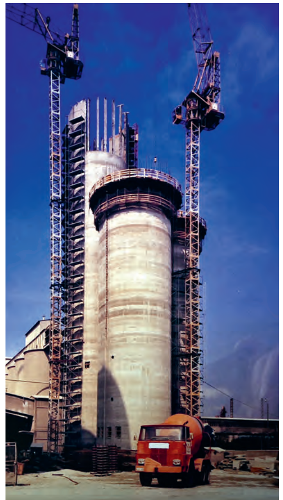
Zementsilo mit 10.000 t Fassungsvermögen, Ende 1971 fertiggestellt.
