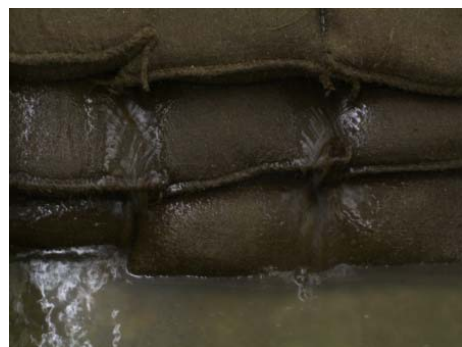
Abb. 68: Sickerwasseraustritt 1. und 2. Lage
