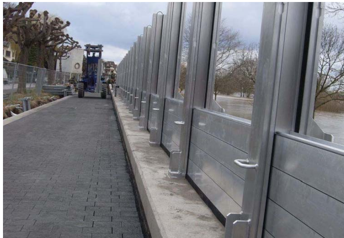
Abb. 80: Dammbalkensystem im Aufbau (Köln) 67
