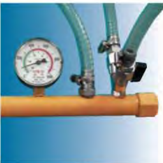
Verteilerleitung mit Kontrollvakuummeter im Sichtbereich.
