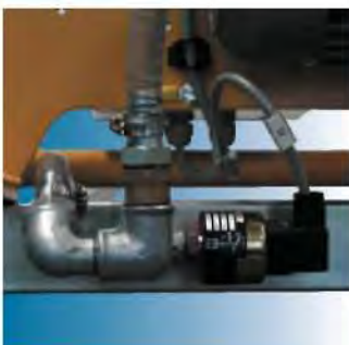
Sicherheitsspeicher mit Vakuumunterdruckschalter und Rückschlagventil.
