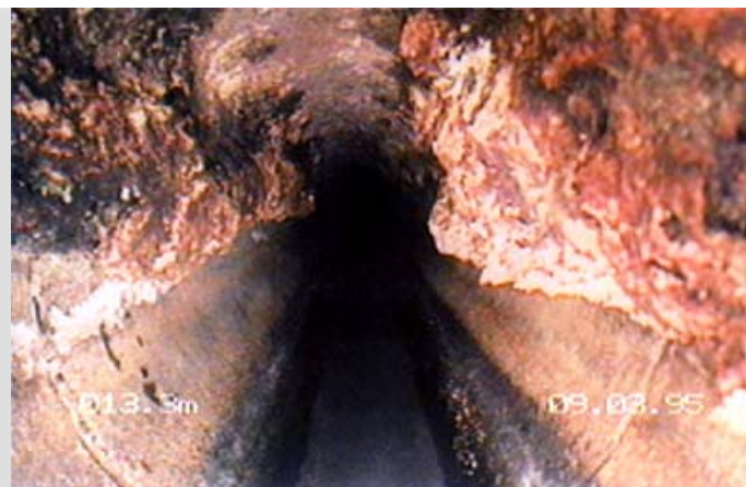
Inkrustation nach erster Reinigung, großflächig
