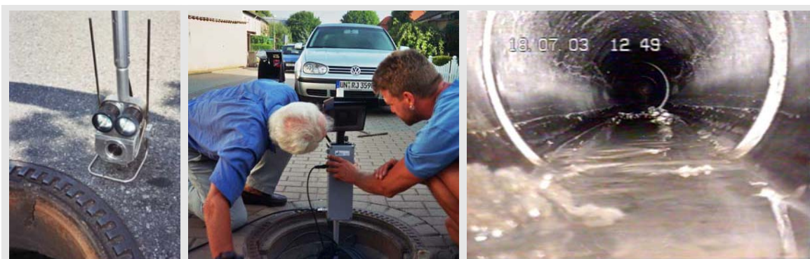
Bild 33: Ablagerungsbewertung durch Einsatz einer Zoom-Schachtkamera
