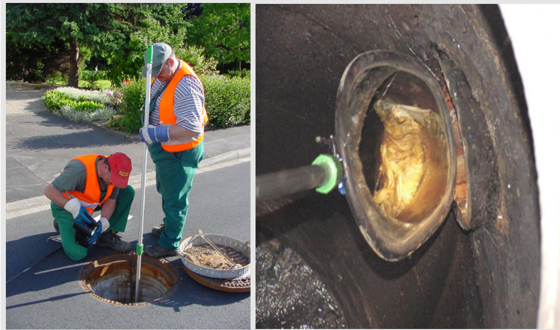
Bild 32: Kanalspiegelung von der Straßenoberfläche aus
