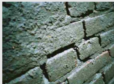
d) Rohrwerkstoff/Kanalzustand: Mauerwerksfugen ausgewaschen
