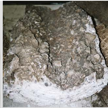
Baustellenrückstände aus dem Kanal
