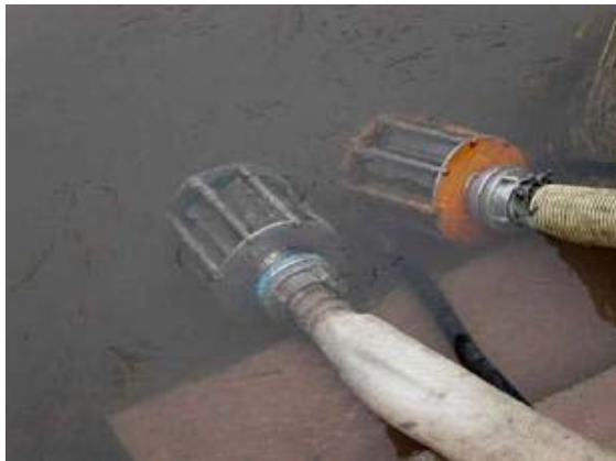
Bild 47: Ejektoren zum Ansaugen von Spülwasser aus einem Vorfluter
