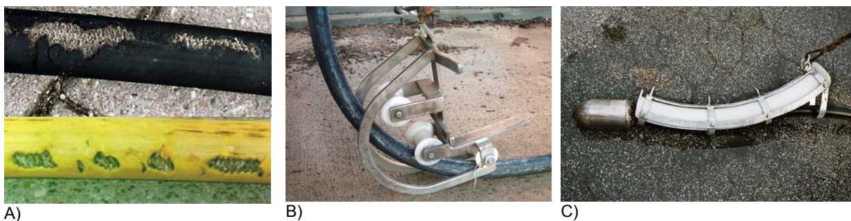
Bild 46: A) Schlauchbeschädigung. B) Umlenkrollen. C) Umlenkstück.
