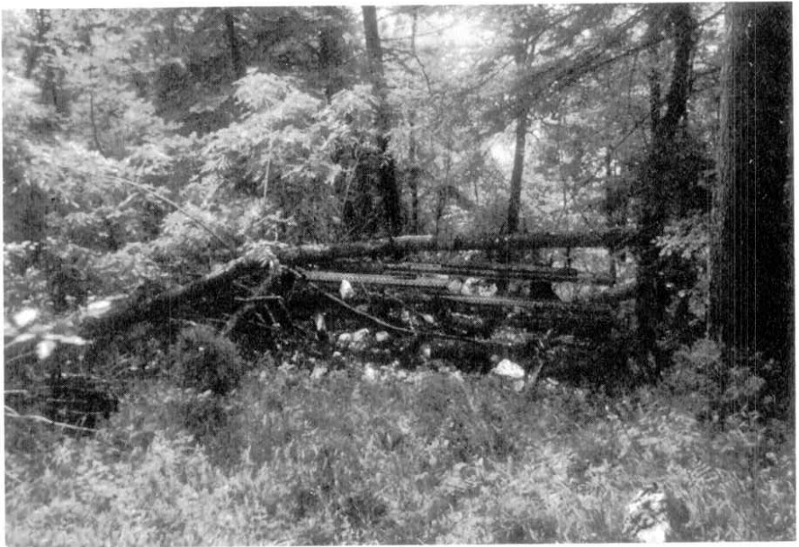
Abb. 4 Zerstörte Stützverbauung in einem Bu-Ta-Fi-Mischwald, der sich in einer späten Phase der Bestandesentwicklung befindet. Zusammenbrechende Stämme gefährden die Funktion der Stützverbauung und stellen den Verbauungserfolg vollkommen in Frage.
