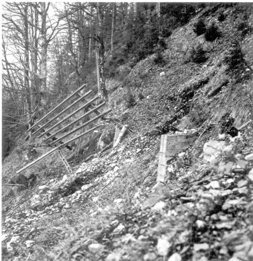
Abb. 5: Durch Lawinenabgang aus dem Wald bewirkte Zerstörung einer Stützverbauung als Folge der Nichtbeachtung der Bestandesdynamik der über dem Verbauungsgebiet liegenden Bestände.
