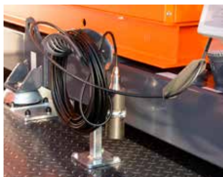
Automatikbetrieb über Höhenstandsonde
