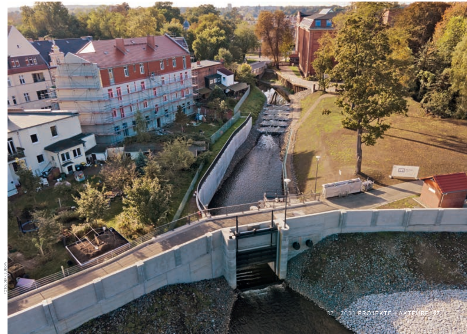
↓ Nach der Fertigstellung sind Fischaufstiegsanlage und Auslaufbauwerk der Egelneißer gut zu erkennen
