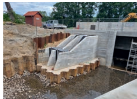
← Die Mündung der Egelneißer mit dem Auslaufbauwerk war ein wichtiger Meilenstein für den Hochwasserschutz in Guben
