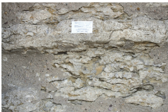
Bild 3 Kalksteinwerkstück mit tiefer reichenden Zerklüftungen
