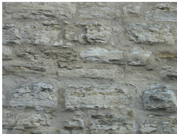
Bild 1 Mauerfläche mit Quadern aus Muschelkalk und Dolomitkalk mit modernem, rötlich-grauem und grauem Fugenmörtel (Spritzverfugung)
