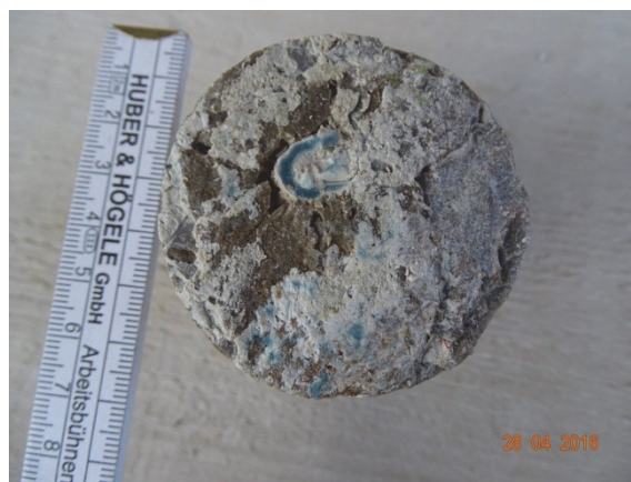
Bild 6 Bohrung S8; Blick auf die Rissebene mit anhaftendem Verpressmörtel, der auch im Bohrkern erkennbar ist
