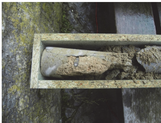
Bild 5 Überbohrter Spritzfugmörtel aus 1971, ein Kieselstein als Setzhilfe und historischer Setzmörtel in guter Qualität
