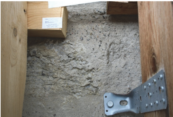
Bild 20 Schlammproben vor Ort, tief reichende Zerklüftung, Vorzustand – Probe 16
