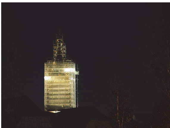
Bild 2 Arbeiten bis in die Nacht? Für den Blauen Turm geht das wie selbstverständlich in Ordnung.
