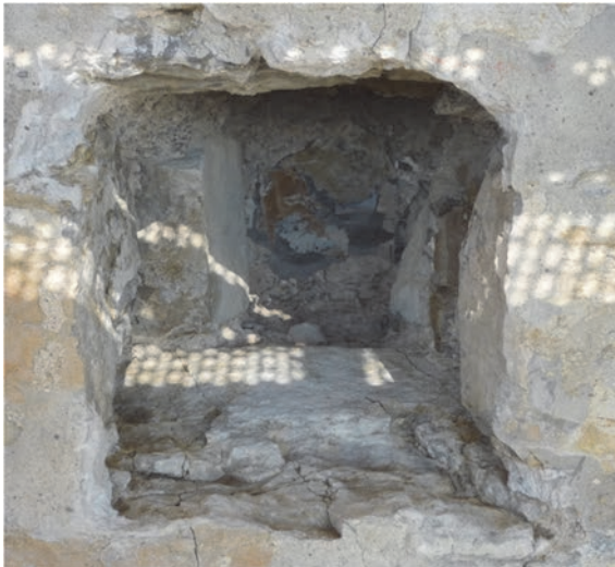
Bild 10 Öffnungsstelle Ost 4: Ansicht der Öffnungsstelle mit einer Tiefe von rd. 80 cm nachdem der Binderstein ausgebaut war. An der Rückseite des Bindersteines ist eine größere Menge Injektionsmörtel (dunkelgrau) vorhanden, an dem noch ein Teil des Bindersteines klebt. Mehrfache Rissbildung im Dolomitmalkstein, zur Steinoberfläche hin kleinteiliger bis bröckeliger Zerfall
