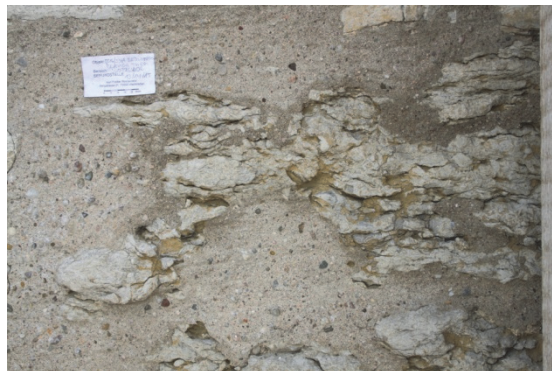
Bild 17 Schlämmpfropfen vor Ort, tief reichende Zerklüftung, Kontrollprobe Festigung ohne Schlämme – Probe 13
