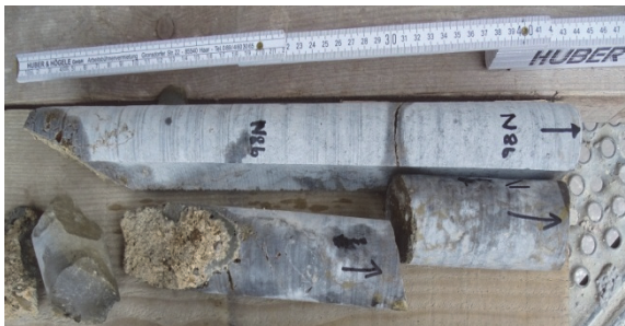
Bild 7 Bohrung N8a und N8b, unterer Bohrkern N8a: Rissebene in ca. 12 cm Tiefe, kein Harz in der Rissebene, nur im Bohrkanal
