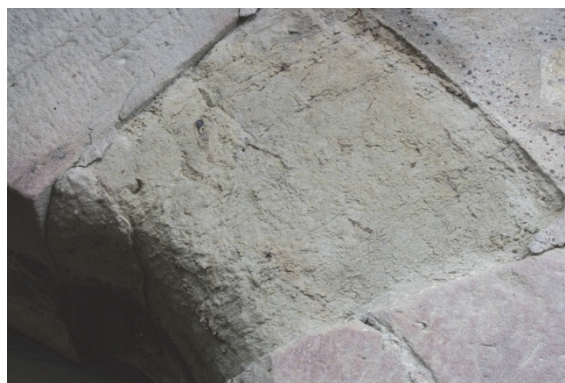
Bild 5 Sandsteinwerkstück am Fenstergewände mit tiefer reichender Rückwitterung
