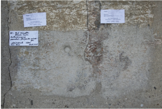
Bild 11 Schlammproben vor Ort, leicht erodierte Oberfläche – Probe 04 Rezeptur Kalksteinmehl / Quarzmehl 1:1 – Bindemittel Syton X 30, Probe 05 – Bindemittel Ludox HSA
