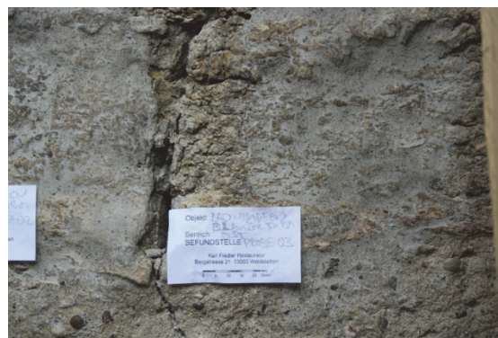
Bild 9 Schlämmpfropfen vor Ort, Detail: Zerklüftete oberflächennahe Steinzone - Probe 03
