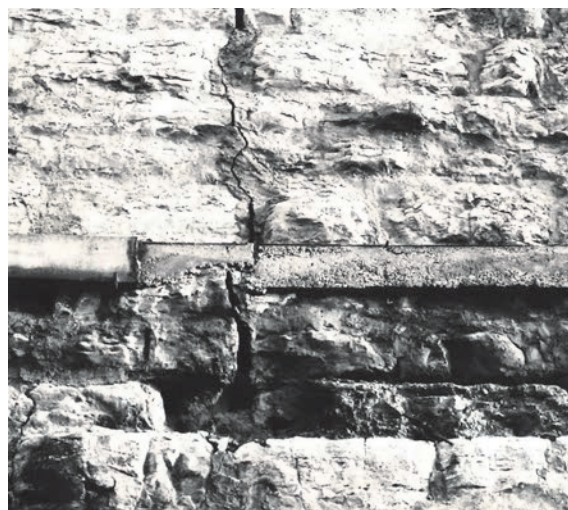
Bild 18 Gerissene Gurtanker und Schäden am Mauerwerk im Jahr 1970 [Quelle: SAIB, Nachlass Klaus Pieper]
