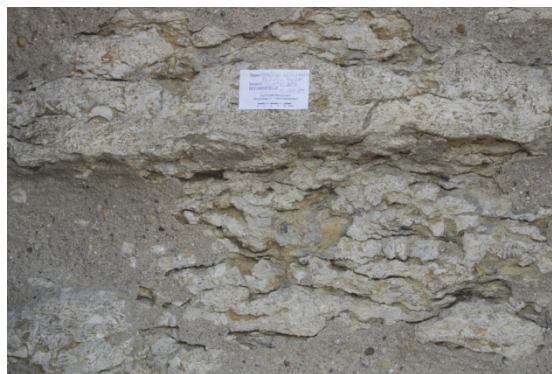
Bild 18 Schlämmpfropfen vor Ort, tief reichende Zerklüftung, Vorzustand – Probe 14, 15
