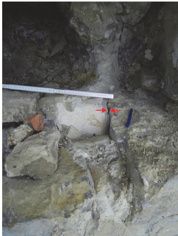
Bild 8 Pieper'sches Injektionsgut hat 1971 einen der »armdicken« Risse im Mauerwerk verfüllt. Unter der Meterstabspitze ist die seitdem weitergehende Aufweitung des Mauerwerks am Riss erkennbar (s. rote Pfeile)
