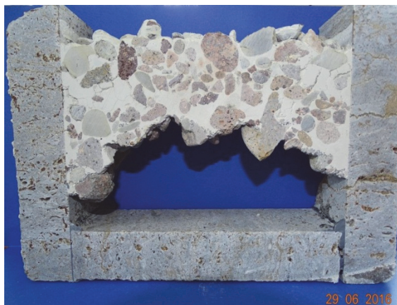
Bild 2 Wannenscheibe mit Feinstzement-Verpressung: Es konnte nur ein Teil des Zuschlaggemisches verfestigt werden, das lockere Material im unteren Bereich wurde beim Sägen ausgespült
