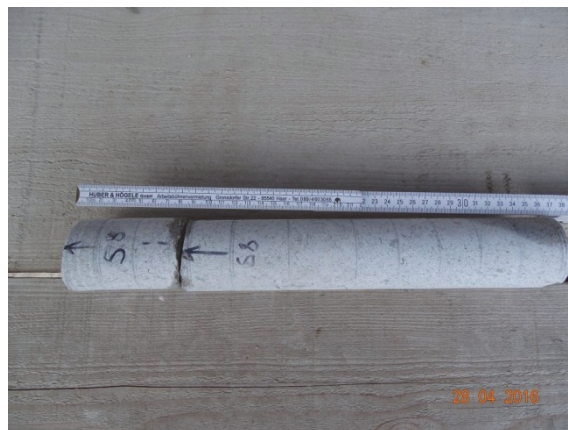
Bild 5 Bohrung S8; in der ca. 8,5 cm tief liegenden Rissebene wie auch im Bohrkern befindet sich Verpressmörtel
