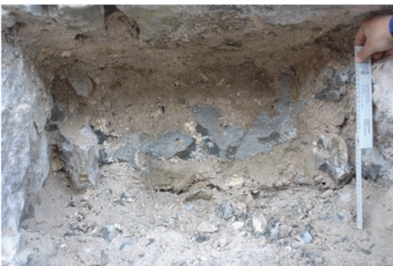
Bild 7 Öffnungsstelle West 1: Ansicht nach dem Herausnehmen des Steins mit gut sichtbarem Injektionsmörtel (mittelgrau)
