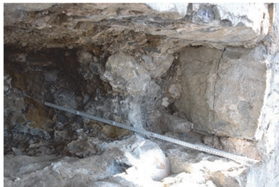
Bild 8 Öffnungsstelle West 2: Rechte Flanke der Öffnungsstelle nach Verbreiterung und Vertiefung bis ca. 100 cm. Es ist deutlich der oberflächenparallele Riss im Kalkstein der Außenschale erkennbar
