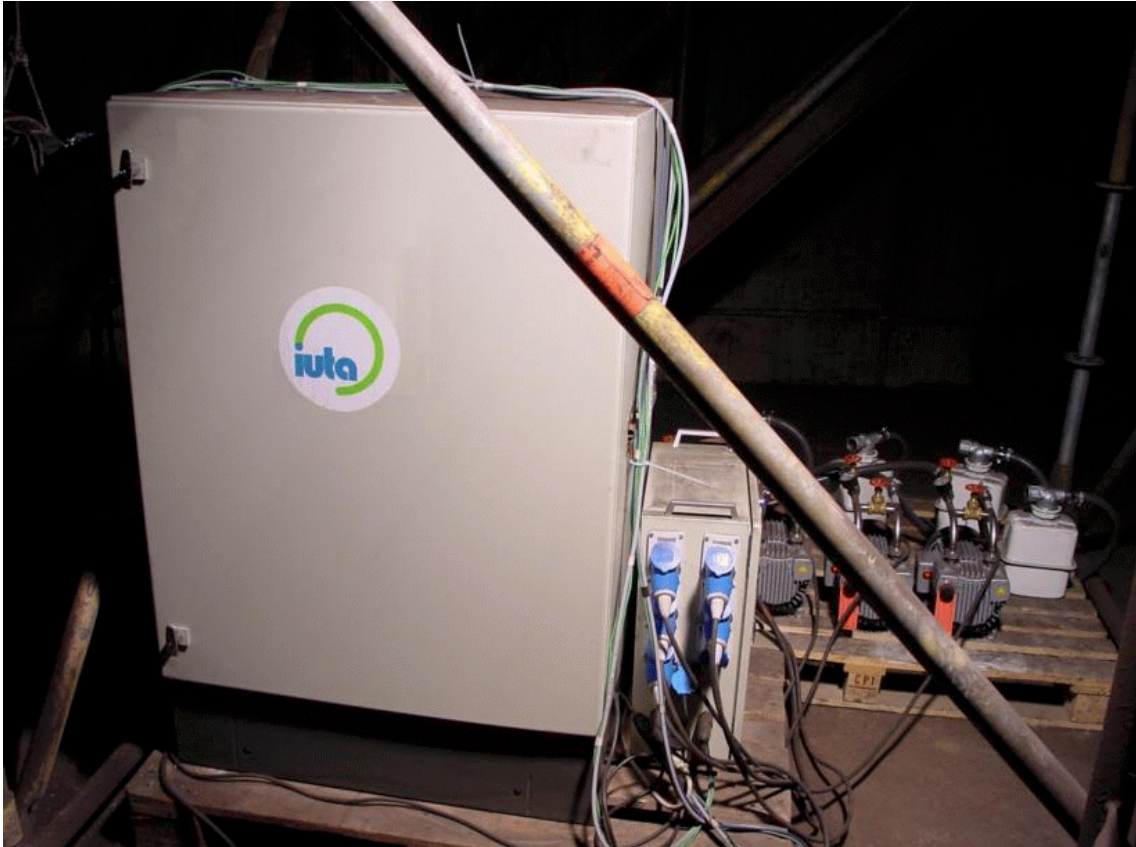
Abb. 5.13: Beheizter Schrank und Schaltschrank
