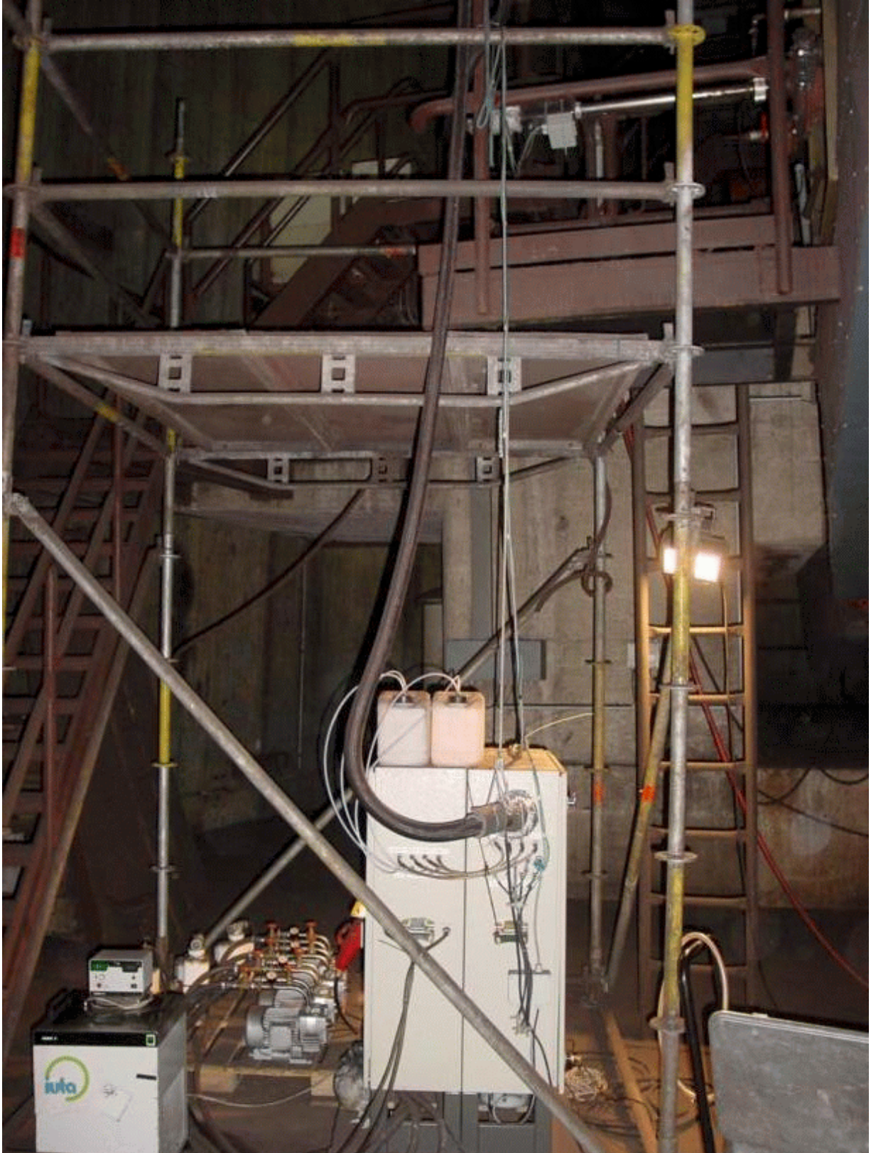
Abb. 5.16: Am Abgaskanal der Sinteranlage
