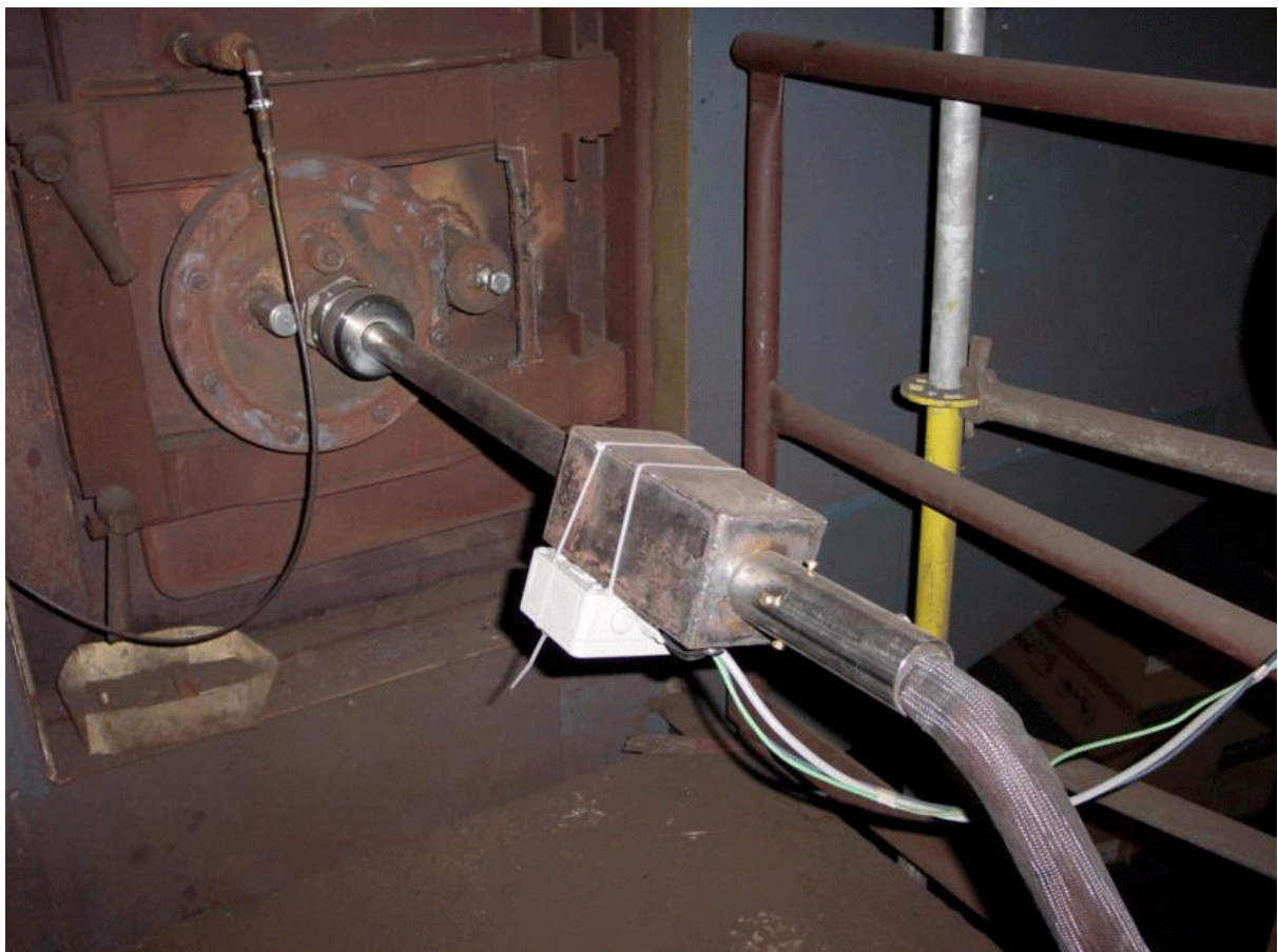
Abb. 5.12: Probenahmelanze im Abgaskanal der Sinteranlage
