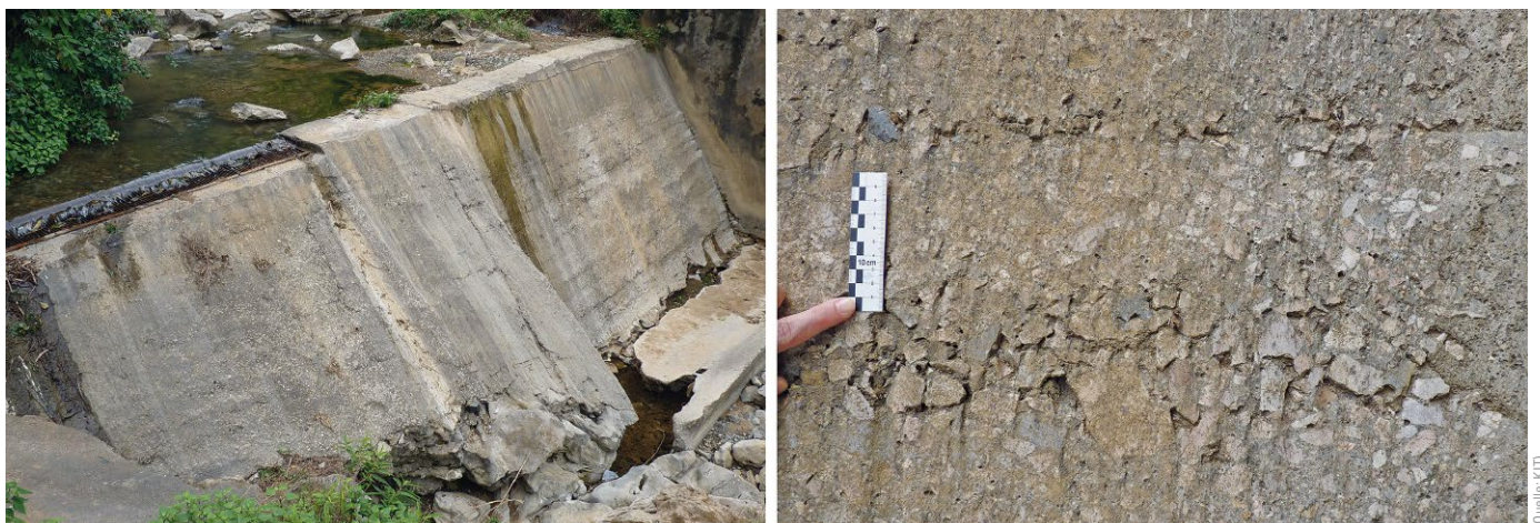
Bild 8 Hydroabrasionsverschleiß an der Wehranlage Seo Ho: Übersicht (links) und Detail (rechts) Hydro abrasive wear at Seo Ho weir: overview (left) and detail (right)
