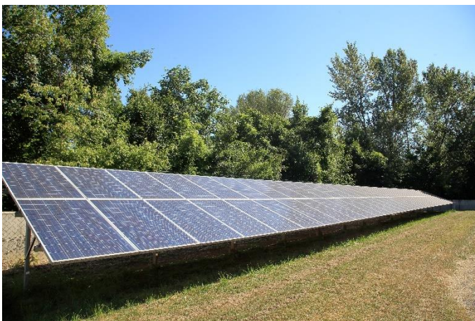
Abbildung 48: PV-Anlage Scharndorf /Quelle: Barbara Krobath®
