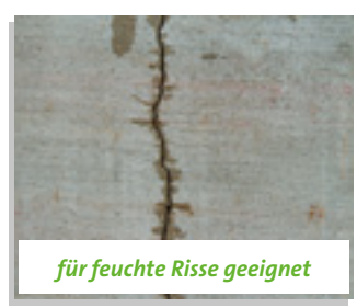
dringt in feinste Risse ein
