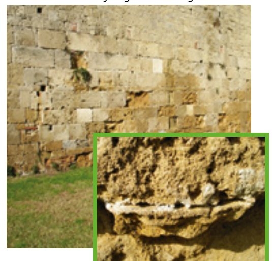
Salzscha den durch aufsteigende Feuchtigkeit
