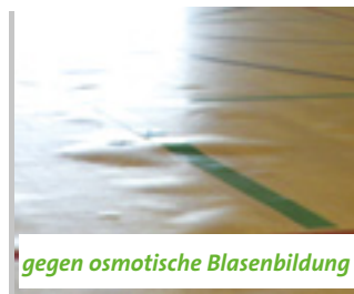
nicht abgedichtete Betonböden
