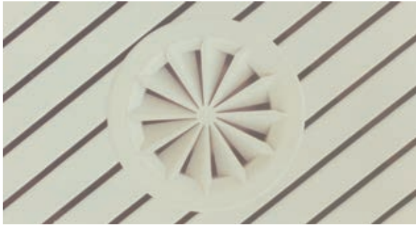
Radialauslass in einer Paneeldecke
