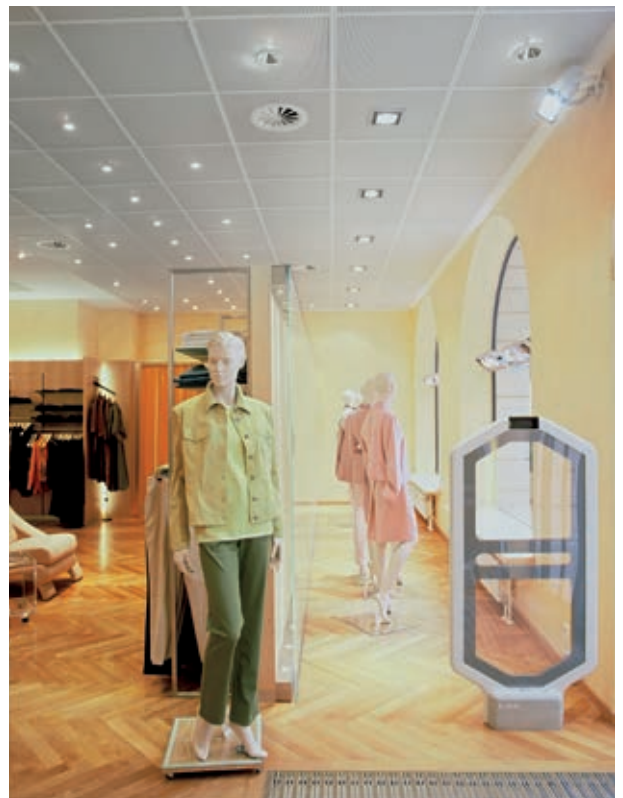
Radialauslass mit runder Sichtfläche in einer Boutique
