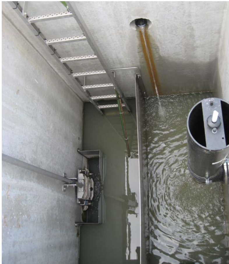
Bild 2-7: Blick in das Ablaufbauwerk mit einstellbarer Abflussdrosselung (rechts), Ablauf zur Lippe mit Schieber und einmündender Umlaufleitung für Betriebszwecke
