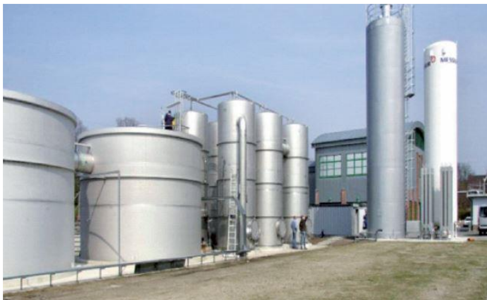
Abbildung 22: Ozonanlage KA Schwerte (Information Ruhrverband)
