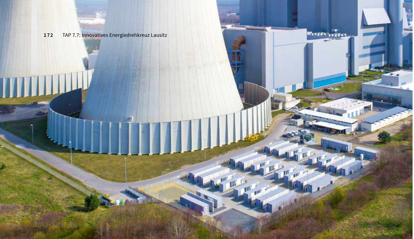
▲ Großbatterie am Kraftwerk Schwarze Pumpe.
