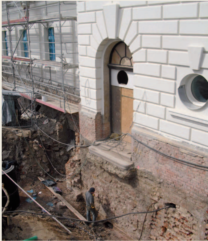
Abb. 71 Außenwand im Kellerbereich vor Sanierung
