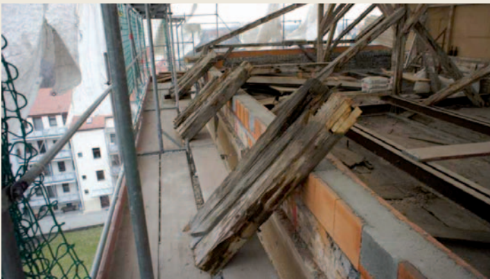
Abb. 97 und 98 Von Hausschwamm befallener Dachstuhl
