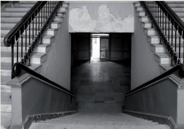
Abb. 20 Treppenhaus vor der Sanierung
