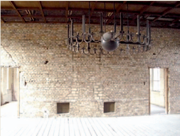
Abb. 77 Sitzungsraum vor Sanierung. Über der Tür (links) sind Risse erkennbar. Der Kronleuchter hängt (leicht verstaubt) in der Mitte
