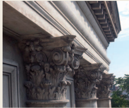
Abb. 41 Unsanierte Säulenkapitelle an der Fassade außen
