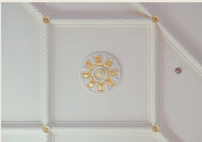
Abb. 53 Detail der Sprinkleranlage im Deckenspiegel
