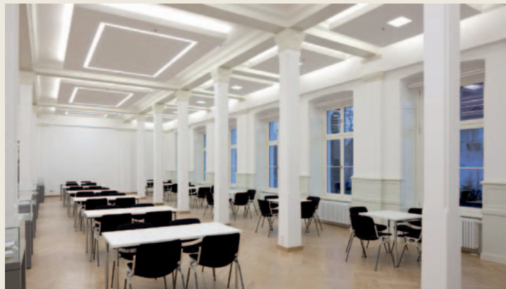
Abb. 51 Die im Rhythmus der historischen Decke eingebrachten Deckensegel im Aufenthaltsraum integrieren Beleuchtung, Sprinkler und Brandschutz
