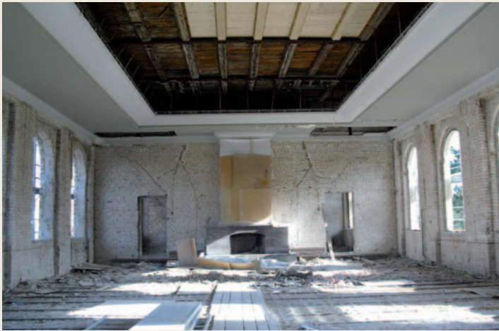
Abb. 68 Empfangssaal der Stadt (vergleiche Abb. 15). Decke und Putz sind entfernt, in der Mitte Kamin und (verhüllt) Wandrelief. Risse durchziehen die Wand
