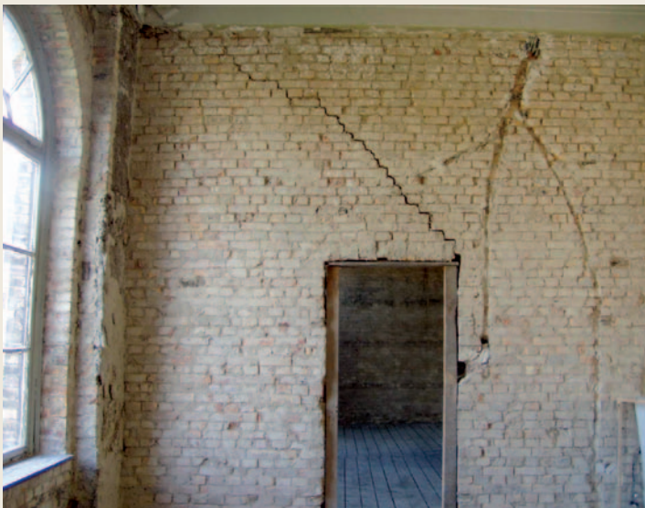
Abb. 69 Detailaufnahme der Risse über der Tür im Empfangssaal
