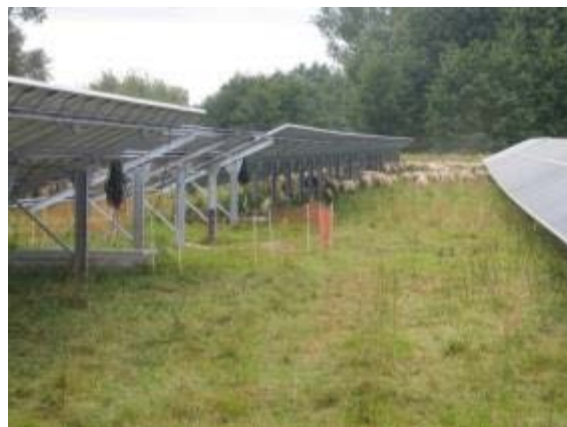
Abbildung 18: Bereiche mit freihängenden Kabeln sind auszuzäunen (Foto: M. Jurkschat).
