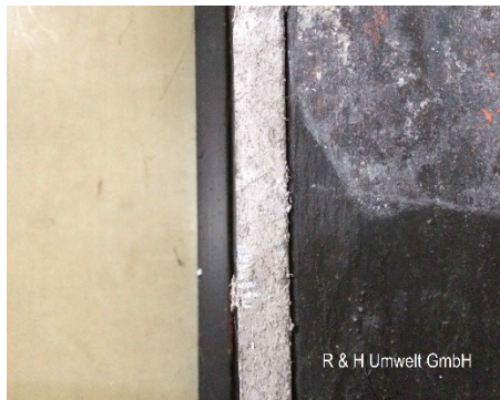
Abb. 1: Verdeckt als Zwischenwand eingebaute Promabestplatte
