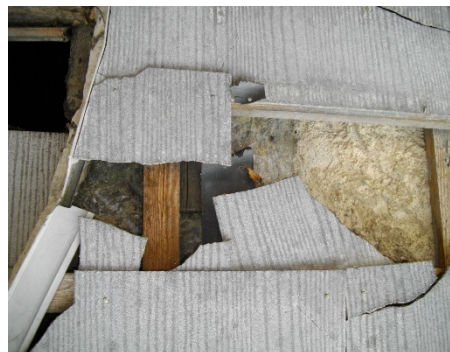
Abb. 9: Beschädigte Fassade mit Asbestzementschindeln und freiliegender Mineralwolle
