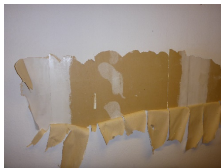
Abb. 14: Gipskartonspachtelmasse hinter einer Tapete
