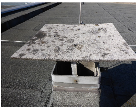
Abb. 8: Entlüftungsschacht mit Asbestzement
