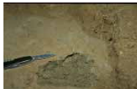
Durchwurzelung einer Tondichtung.
