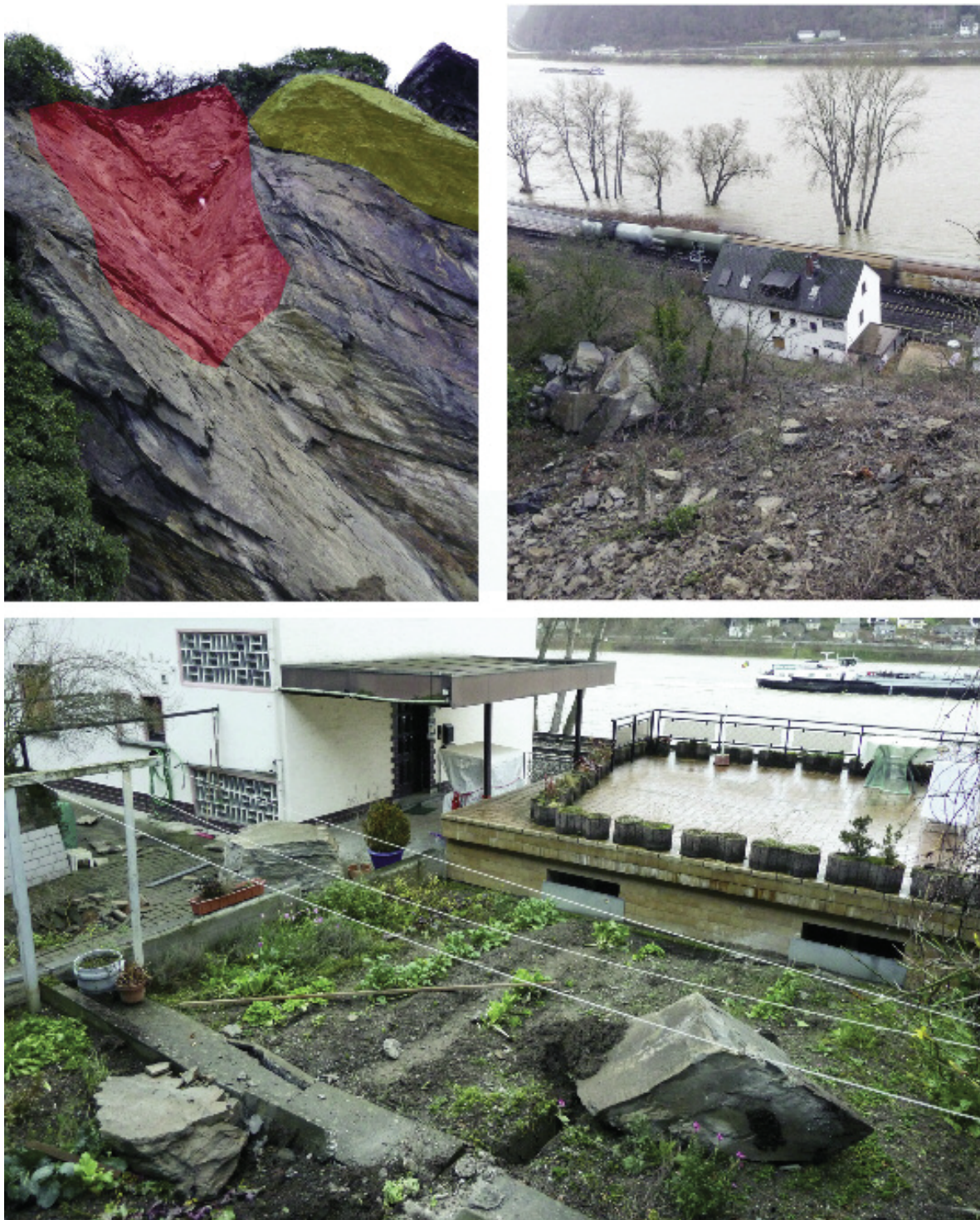
Abb. 5: Fotodokumentation des Felssturzes vom 05.01.2012. Das Foto oben links zeigt die Ausbruchsstelle der Felsmassen (rot hinterlegt). Unmittelbar daneben sind weitere absturzgefährdete Blöcke vorhanden (gelb hinterlegt). Im Foto oben rechts ist im Vordergrund die Geländestufe unterhalb der Ausbruchsstelle zu erkennen. Hier kam ein Teil der Sturzmassen (etwa 20 \text{ m}^3 ) zum Liegen. Das Foto unten zeigt die bis zu den Häusern gestürzten Felsblöcke. Diese weisen Kantenlängen von etwa 0,6 bis 1,5 m auf (Fotos: WEHINGER vom 06.01.2012).
