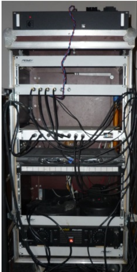
DSP und Verstärker Rack
