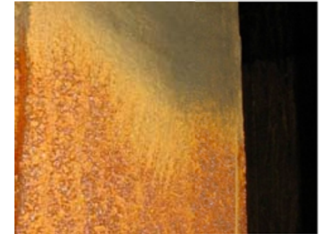
Korrosion in einer Reingas führenden Leitung
