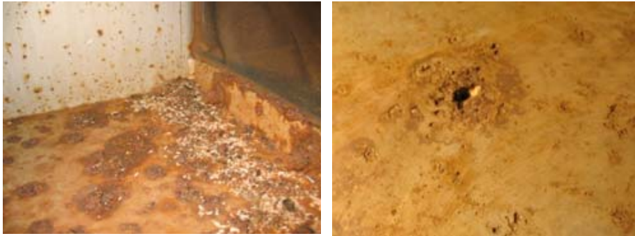
Lochfraß im Rohgaskanalbereich
