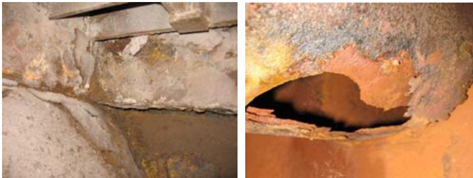
Korrosion im Strömungsverteileraum und an einer Spülgasleitung
