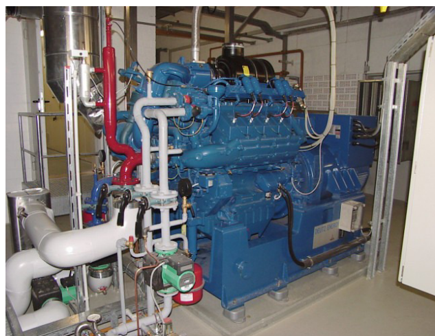
Modul des Blockheizkraftwerks
