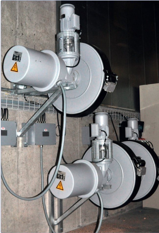
Motorleitungstrommeln mit Flachleitung für verschiebbare Bühne, spiralförmig wickelnd, Montage inkl. Konsolen und Verdrahtung durch MIBAG AG
