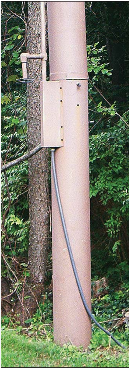
Pegelüberwachung an einem Fluss als Flutwarnanlage
