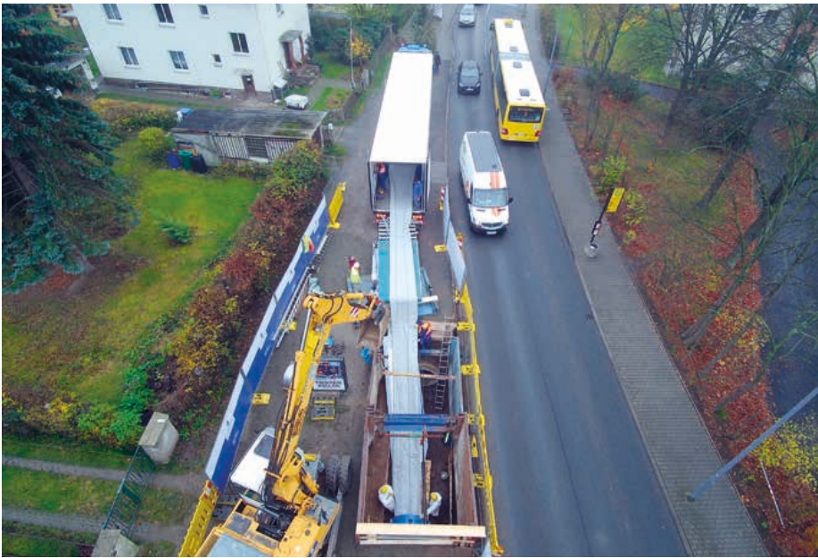
Die kurze Bauzeit und die minimierten Behinderungen des Verkehrs waren wesentliche Argumente für den Einsatz dieses Verfahrens in Dresden.
