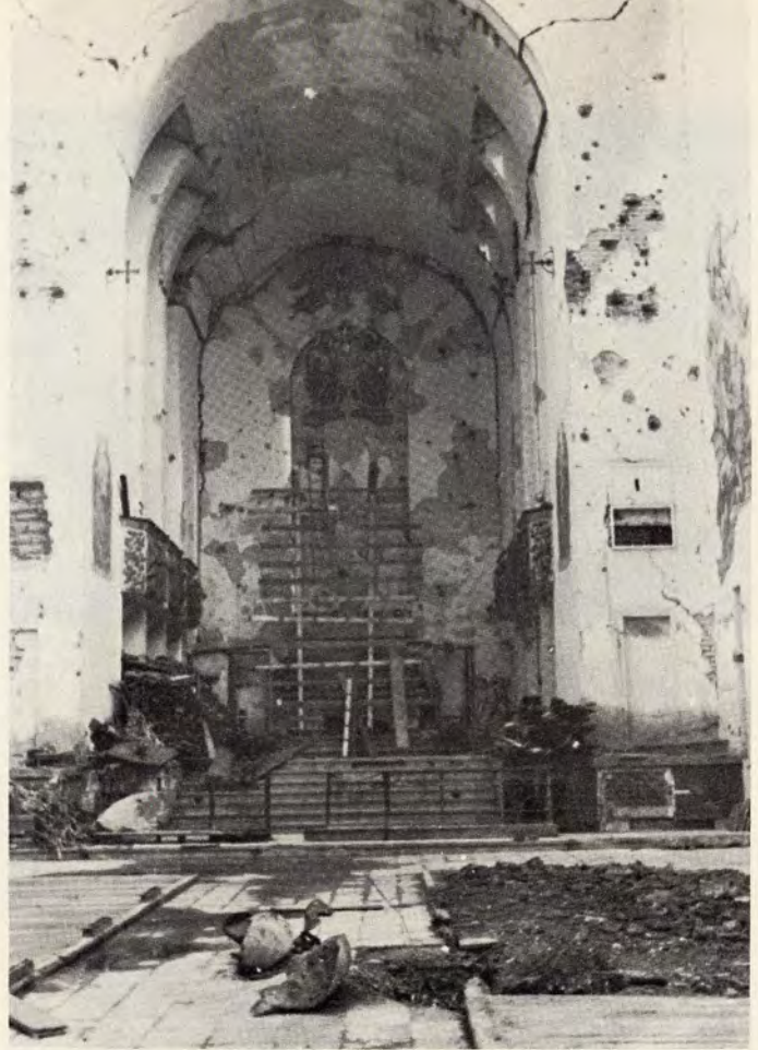
Das Langhaus war bis auf das Presbyterium durch Sprengbomben zerstört worden.
