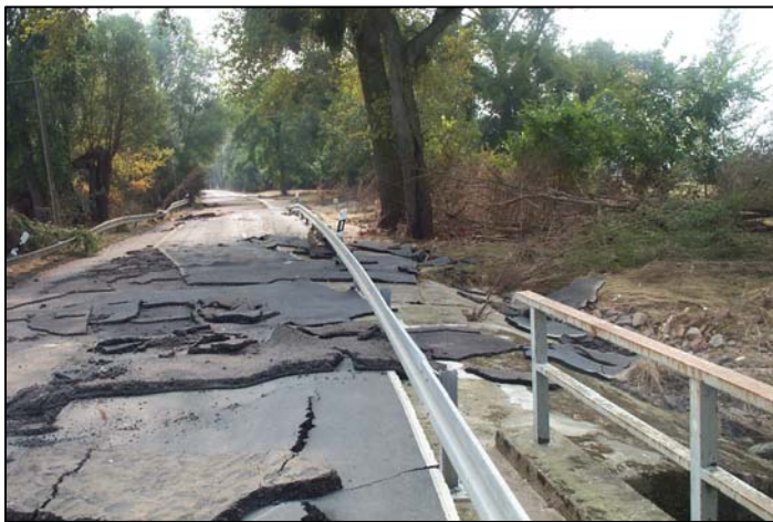
Abbildung 11 Schäden an kommunaler Infrastruktur
