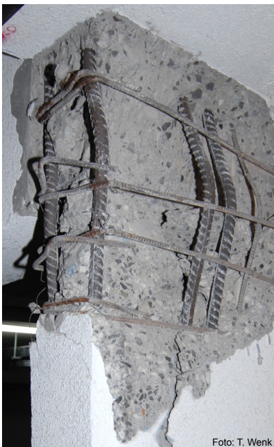
Druckversagen im Untergeschoss eines 24-stöckigen Hochhauses in Concepción, Chile im 2010: Bügel mit 90°-Haken öffnen sich.
