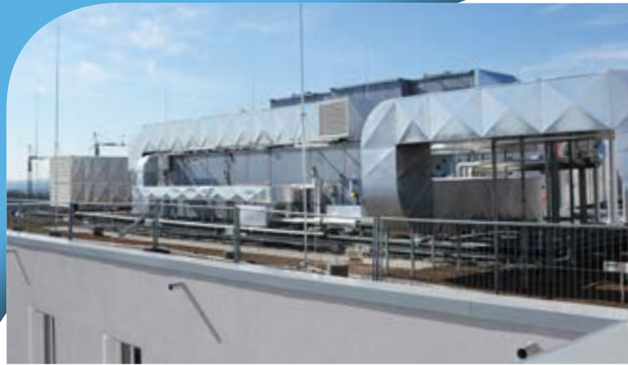
Bilder oben: Neben den Lüftungsanlagen im Haus gibt es auch auf dem Dach lufttechnische Anlagen. Auch die Rückkühler für die Kälteanlagen sind hier platziert. Hierbei kommen für verschiedene Anwendungsbereiche unterschiedliche Systeme zum Einsatz. Trotz der Aufbauten ist 50 Prozent der Dachfläche begrünt.
