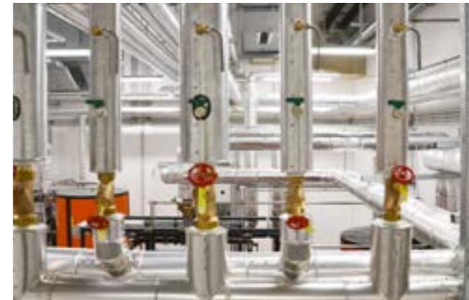
Bilder oben: Zirkulationspumpen und mehrere Warmwasserspeicher mit einem Fassungsvermögen von je 1.200 Litern stellen die Warmwasserversorgung des Gebäudes sicher. Über mehrere Stränge wird das Wasser im Haus verteilt und zu den Verbrauchern transportiert. Um den Wärmeverlust so gering wie möglich zu halten, werden Rohrleitungen – wie abgebildet – mit Wolle gedämmt. Die erkennbaren Strangregulierventile dienen zur Einregulierung des Volumenstromes.
