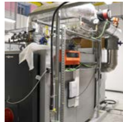
Bild unten: Ein sogenanntes Blockheizkraftwerk versorgt das Gebäude mit elektrischer Energie und erwärmtem Heizungswasser. Im Regelbetrieb wird es mit Erdgas betrieben, für den Notfall können die herkömmlichen Heizkessel auch mit Öl betrieben werden.
