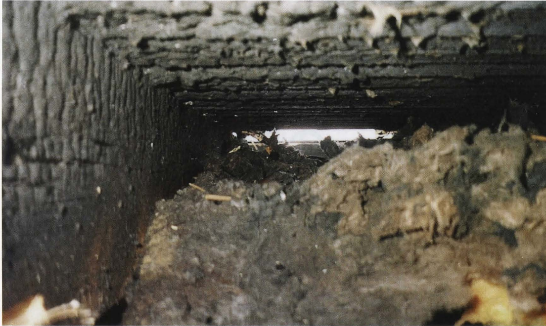
Abb. 1: Brandweiterleitung im Hohlraum durch Pyrolysegase (Dämmung war hier nichtbrennbar!)
