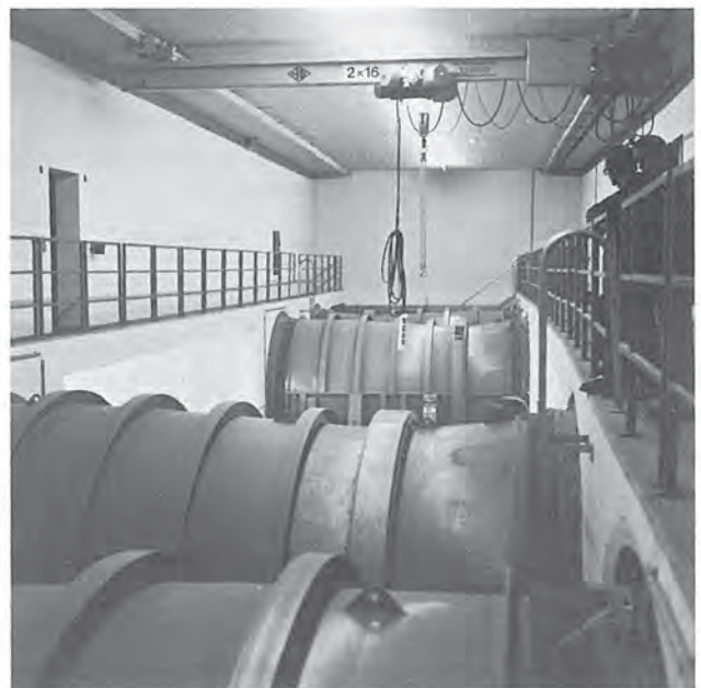
Eine von sechs Lüftungszentralen mit Ventilatorleistungen zwischen 430 kW und 2920 kW!
