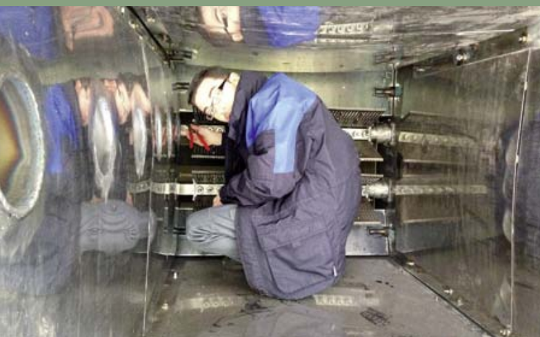
Blick in den Brennerkanal, neue Versuche mit verbesserten Gasdüsen
