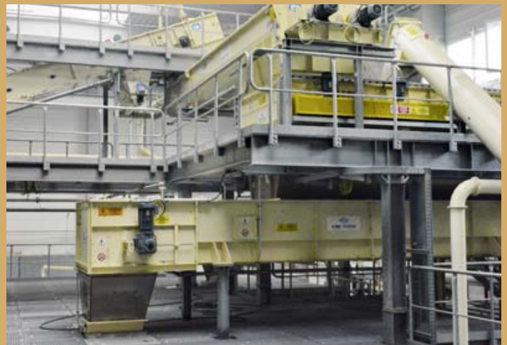
Scheibensieb über den Mittelschicht-Streumaschinen
