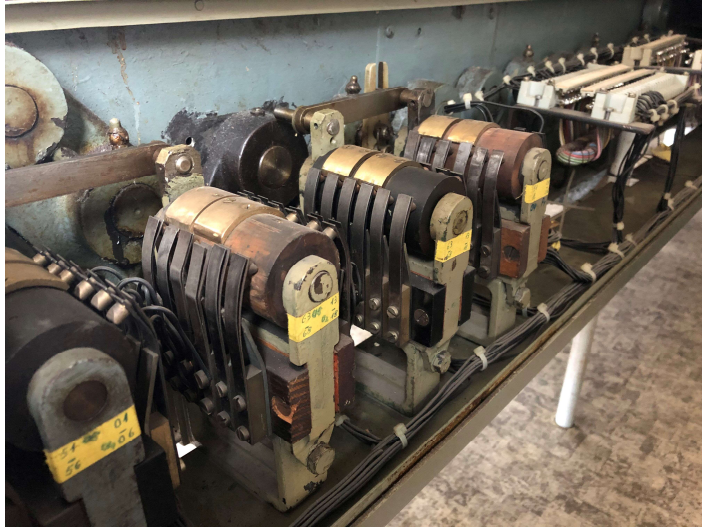
Abgriff an den Walzenkontakten zur Identifikation der Fahrstraße
