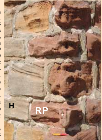
Abb. S 2.2 Sandstein-Skulpturierung durch Verwitterung am Gradierwerk von Bad Dürkheim (erbaut 1847); H - Haardt- Sandstein , RP - Roter Pfälzerwald Sand- stein ; beide Trias [Foto: Schroeder]
