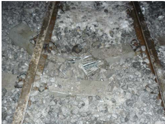
Schäden an den Gleisanlagen.
