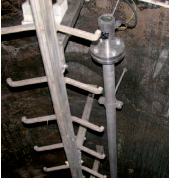
Bild 22: Radarsensor zur berührungsfreien Messung der Stauhöhe der Fürwiggetalsperre Fig. 22: Continuous water level measurement by radar at the Fuerwigge reservoir
