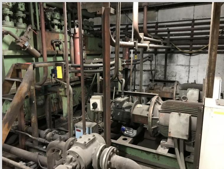
Figur 6.1.4. Hydraulikpumper og motorer.
