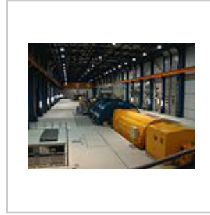
Moderner Turbogenerator (gelbe zylindrische Einheit in der Mitte); 800 MW; Maschinenhaus Kraftwerk Schwarze Pumpe
