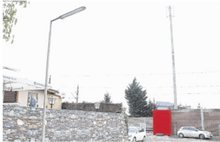
Der Handymast fristet sein Dasein in einem Siedlungsgebiet.
